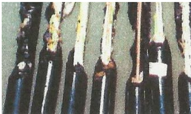
Danos em cabos ópticos e elétricos provocados por roedores: dão origem a falhas de transmissão e curtos-circuitos.
